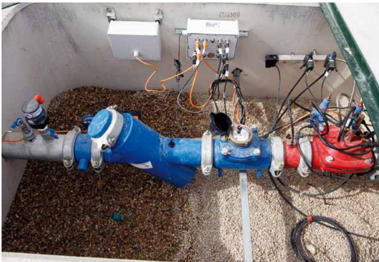
Telecontrol de hidrante.
