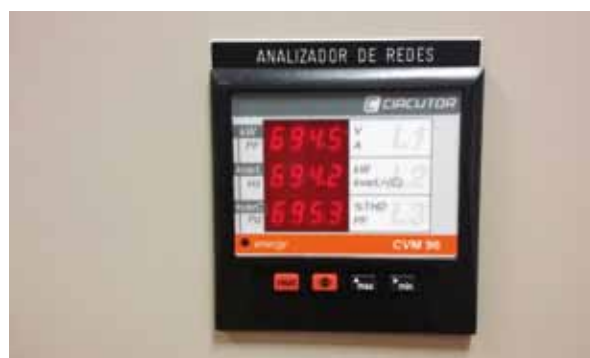
Analizador de redes para medición de parámetros eléctricos.
