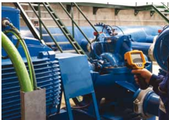
Termografía Infrarroja para diagnóstico de bomba.
