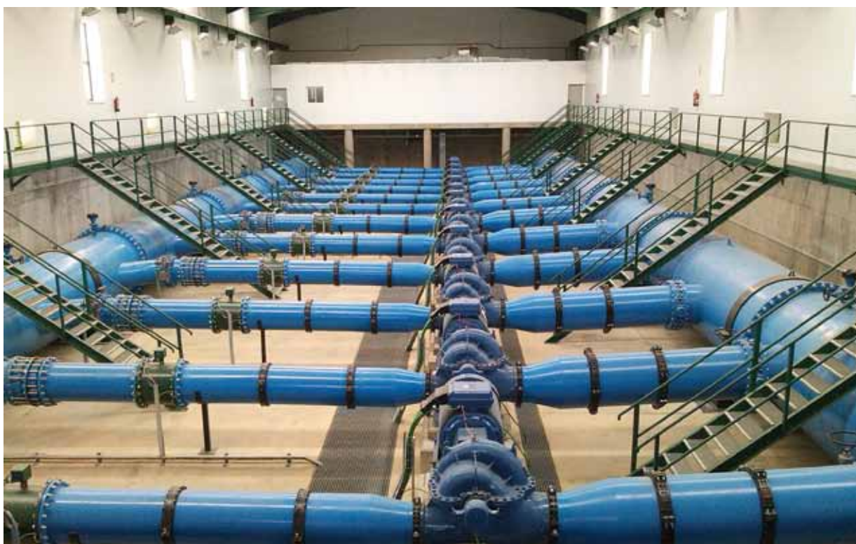
Estación de bombeo con bombas horizontales de cámara partida.
