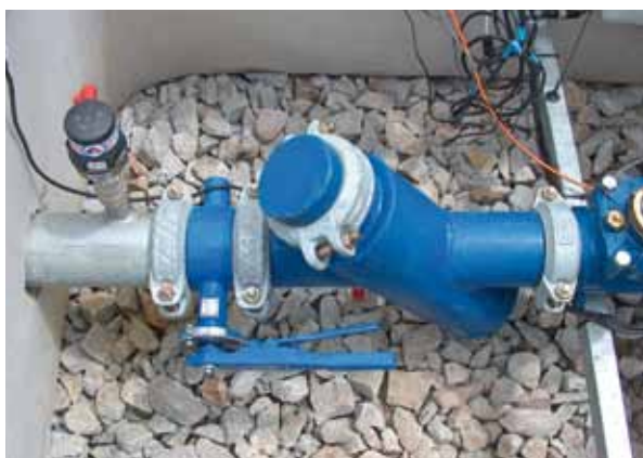
Filtro cazapiedras en hidrante. Realizar varias limpiezas durante la campaña de riego.
